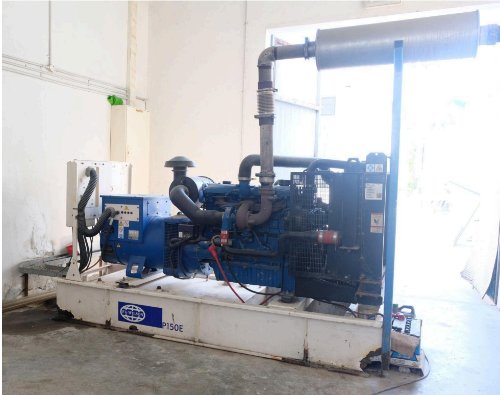
Figure 16. Backup generator in Maternidade-Escola de Nossa Senhora de Fatima
