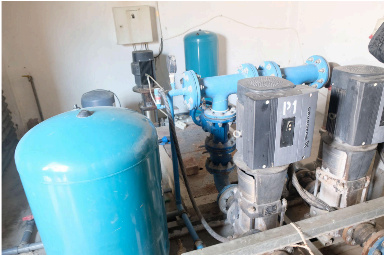
Figure 14. Water filtration system in Maternidade-Escola de Nossa Senhora de Fatima
